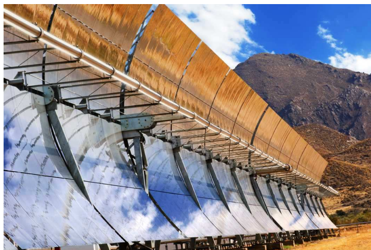
Collecteur cylindro-parabolique de la centrale espagnole Andasol, Source : DLR
