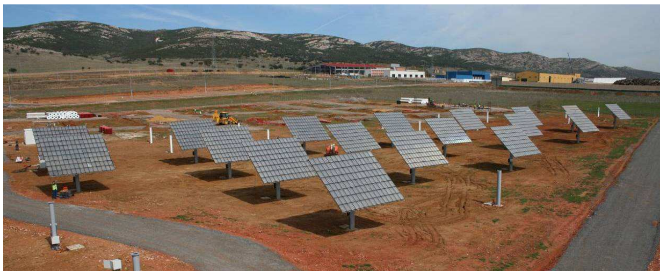
Figure 4 : Photo de la première installation d'un concentrateur FLATCON® de 100 kW de Concentrix Solar à Puertollano, Espagne, février 2008.
