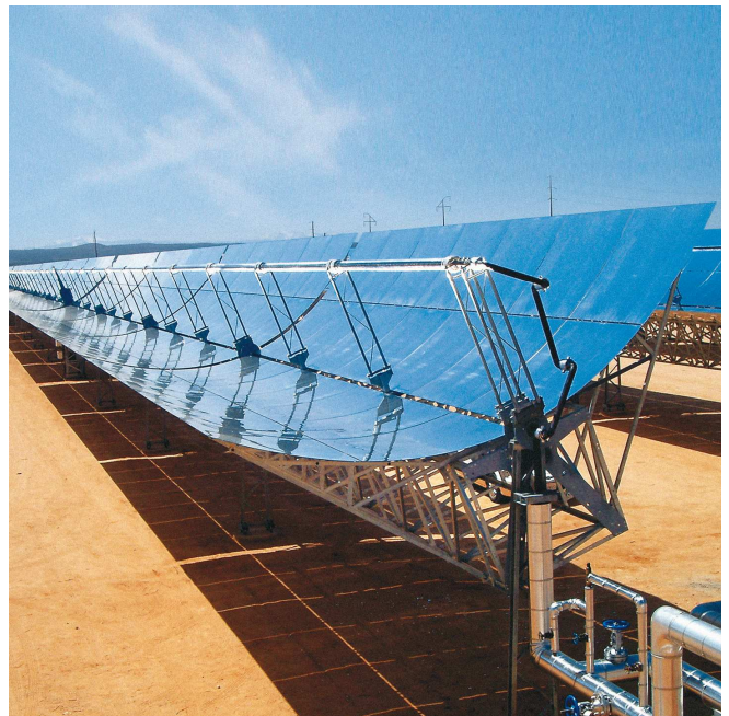
Capteurs cylindro-paraboliques sur un champ solaire
